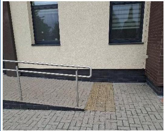
7 pav. Pagrindinio įėjimo panduso neteisingai panaudotas taktilinis paviršius, asmenį su regos negalia nukreipiantis į pastato sieną arba kitas lauko erdves.
