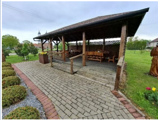
2 pav. Lauko pavėsinė su plačia nuovaža, tačiau nuovaža ir laiptų pakopos nepažymėtos kontrastingomis juostomis.
